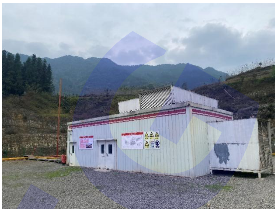
YS108H2 平台 10kv 变电站及 DTY315 压缩机
