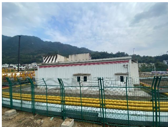
YS108H2 平台 10kv 变电站及 DTY220 压缩机
